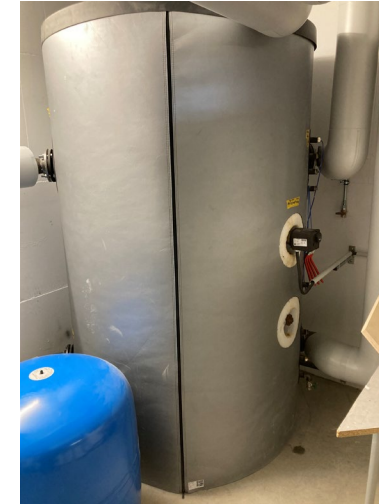
Puffer- speicher „Heizen“
