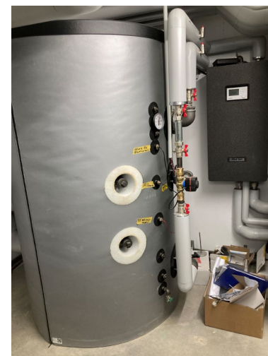
Pufferspeicher „Warmwasser- bereitung“
